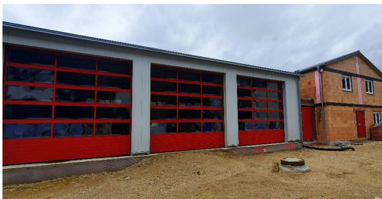
Der Mörnsheimer Marktgemeinderat beschloss die Kostenübernahme für den Lkw-Führerschein für aktive Feuerwehrleute. Der Auftrag für Ausrüstungsgegenstände für die Ortsfeuerwehren wurde ebenfalls vergeben. Im Bild das im Bau befindliche neue Feuerwehrgerätehaus in Mörnsheim.
